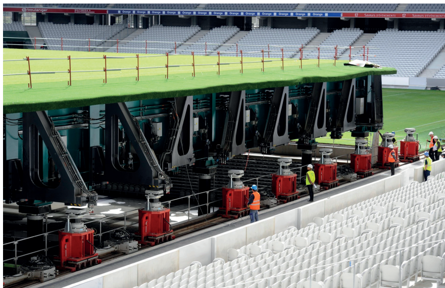
Il sistema di martinetti idraulici che consente di sollevare metà del campo di gioco
